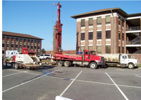
Geothermal Langley AFB, VA & Ft. Hunter Liggett, CA
